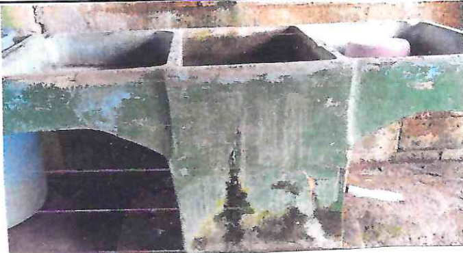
Foto 1: sustitución de pila, se sale el agua por sus gretaduras
