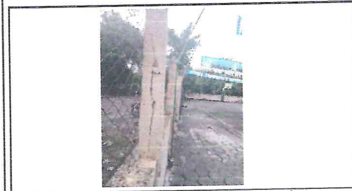
Foto 3: Columna en mal estado de muro perimetral
