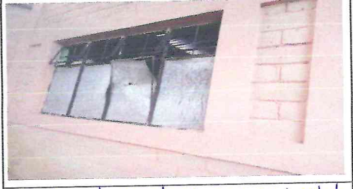
Foto 2: segunda ventana en mal estado.
