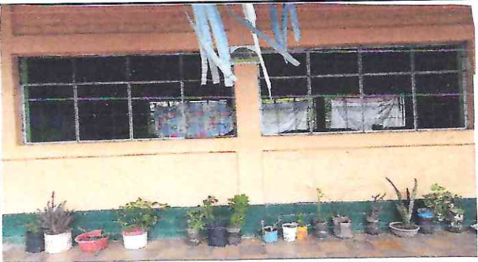
Foto 3: Ventana en mal estado
