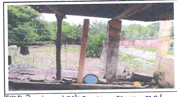
Foto 6: Parales, techo en muy mal estado.
