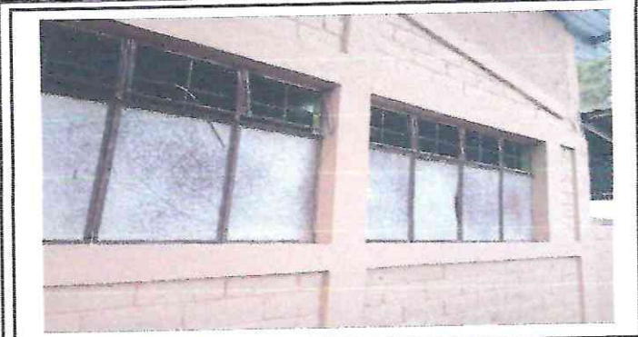
Foto 1: ventana de la dirección en mal estado
