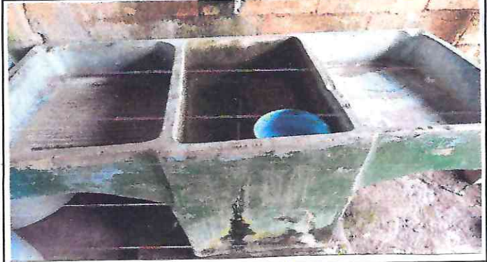
Foto 2: Pila en mal estado -
